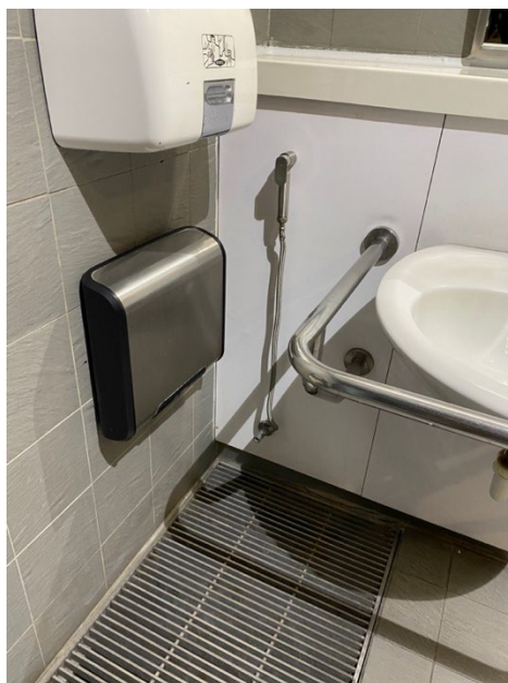
写真2 駅多目的トイレのシャワー設備
