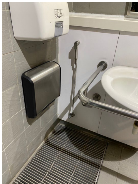
写真 2 駅多目的トイレのシャワー設備
